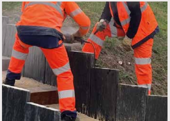
Création d'un chemin reliant le passage piéton de la départementale à la Grand'rue
